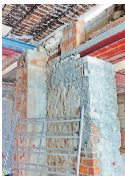
Stahlträger und Asbest sind im „Stubendurchgang“ verbaut.
