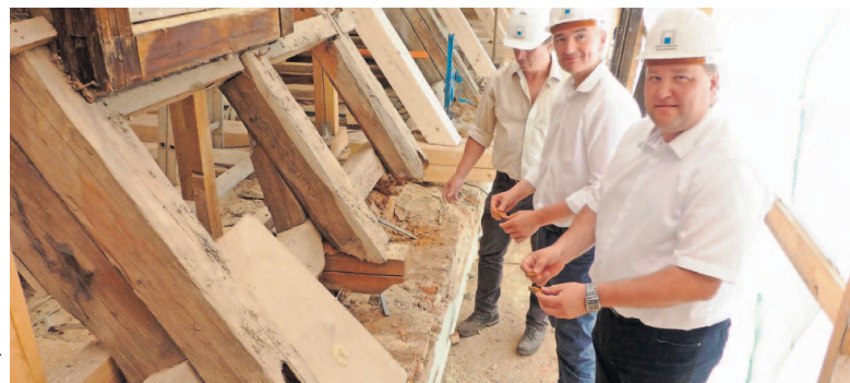
Einige marode Balken im Dach der Klosterburg zerbröseln den Verantwortlichen zum Teil zwischen den Fingern. Zeit, dass sich das ändert.
