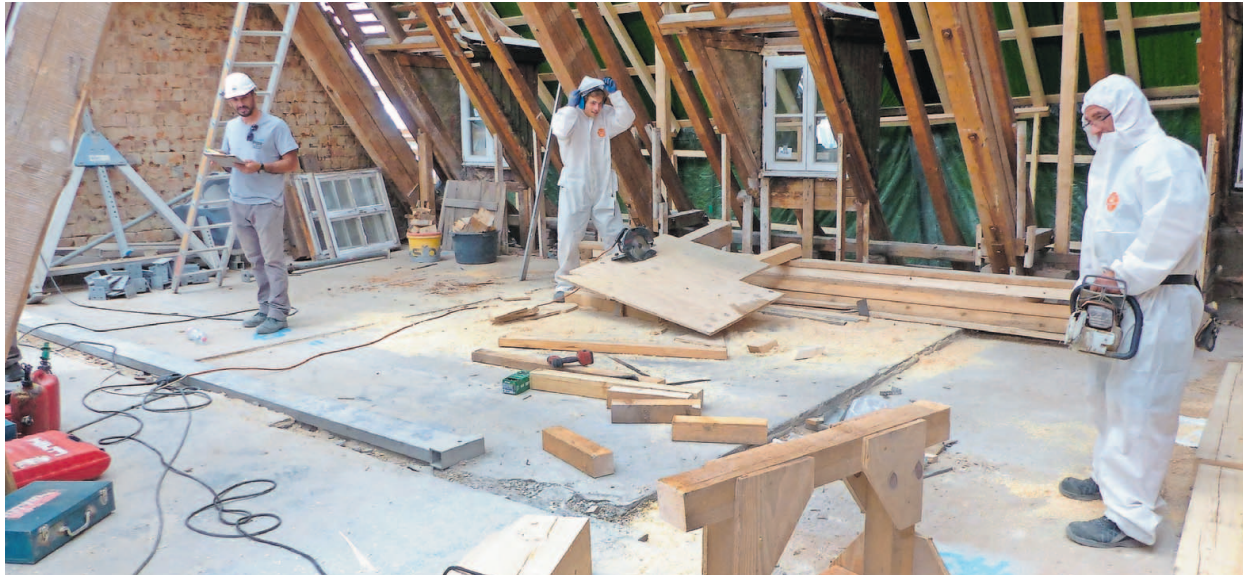
Eine schweißtreibende Angelegenheit: Am Dachgebälk der Klosterburg arbeiten die Zimmerer in Schutzanzügen.
